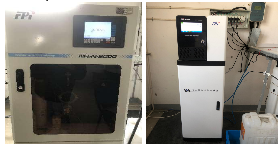
氨氮在线监测设施
