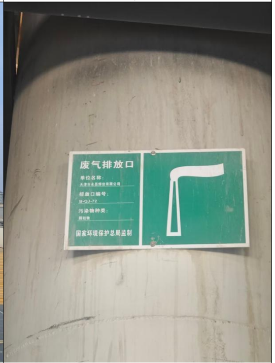
排气筒B-QJ-72标识牌
