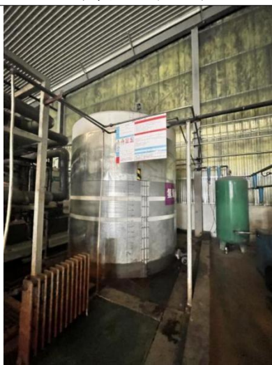
氢氧化钠储罐
