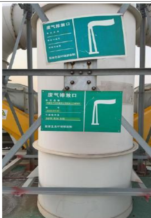
排气筒 P8 标识牌
