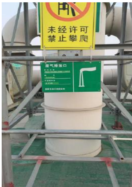
排气筒 P7 标识牌
