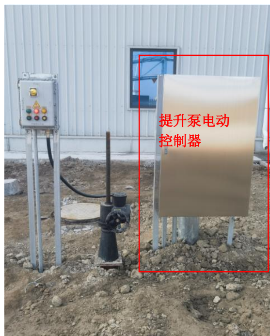
雨水排放口 2 截止阀及提升泵
