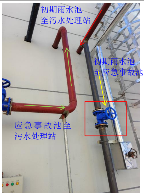
初期雨水至事故水池切换阀
