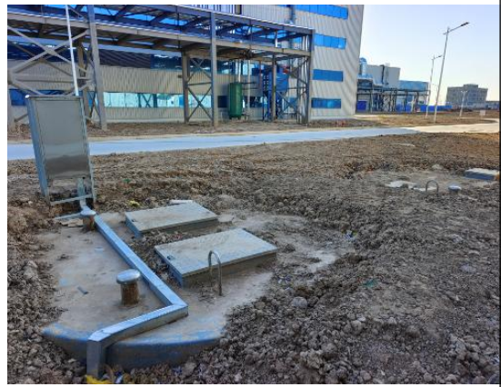
仓库外事故水罐
