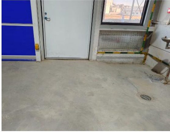
仓库防溢流坡
