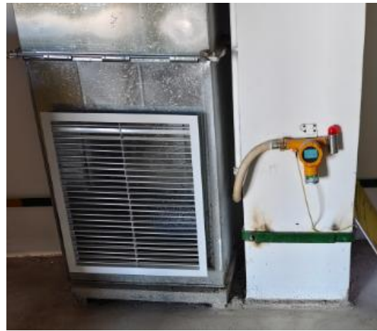
危废暂存间可燃气体报警器
