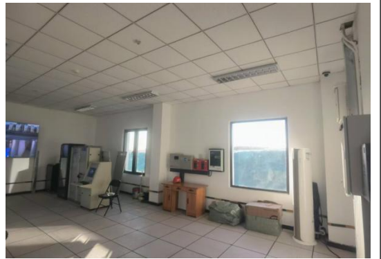
消防控制室监控
