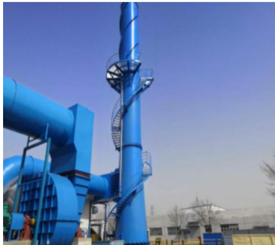
三级过滤+沸石转轮+RTO 装置
