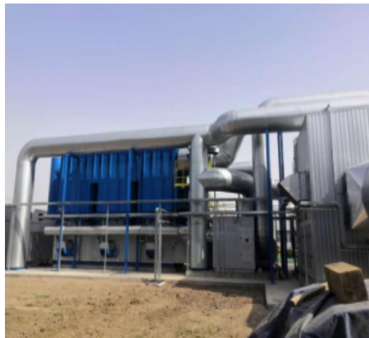
三级过滤+沸石转轮+RTO 装置
