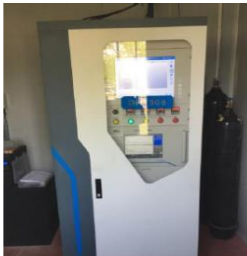
非甲烷总烃在线监测仪器
