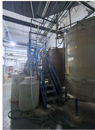
含锌污水处理站
