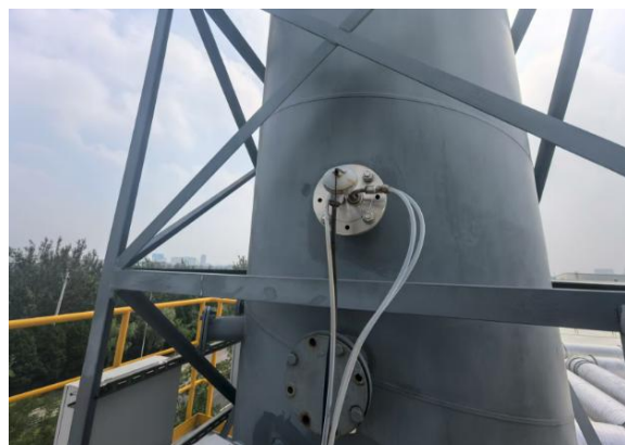
DA001 排气筒采样口
