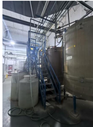
含锌污水处理站
