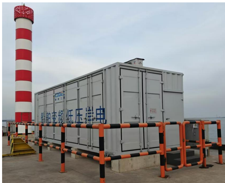
图 7.2-1 码头二期“岸电”系统
