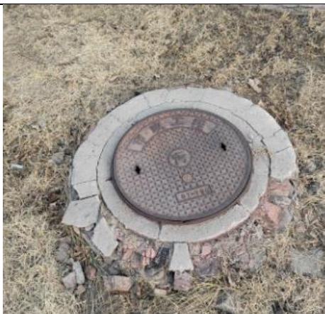
废水排放口 DW001
