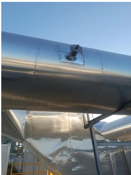
排气筒 P2 进口
