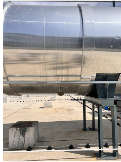
排气筒 P1 进口
