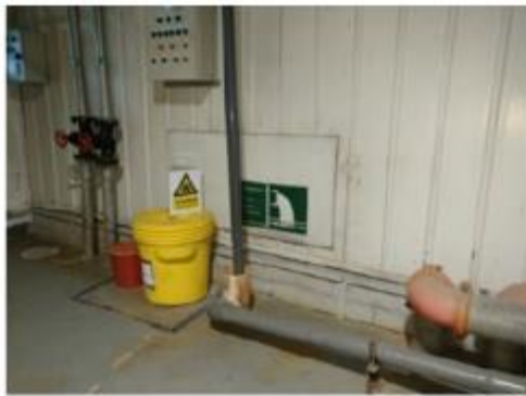
含镍废水车间排放口
