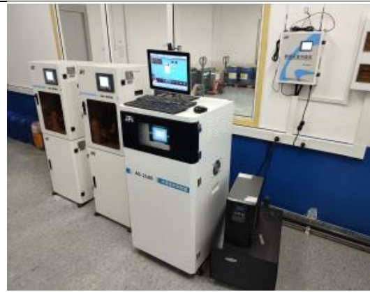
含锌废水处理站总镍和总铬在线监测
