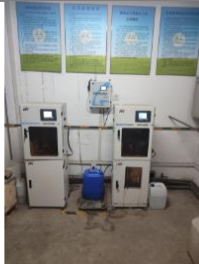
总排口氨氮和 COD 在线监测
