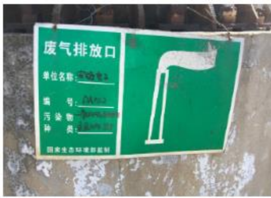
排气筒 DA002 标识牌
