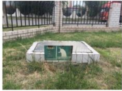
废水排放口 DW001
