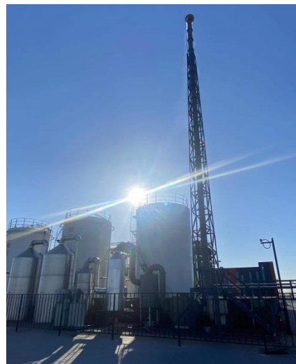
罐区废气治理设施及排放口 DA002(P5)
