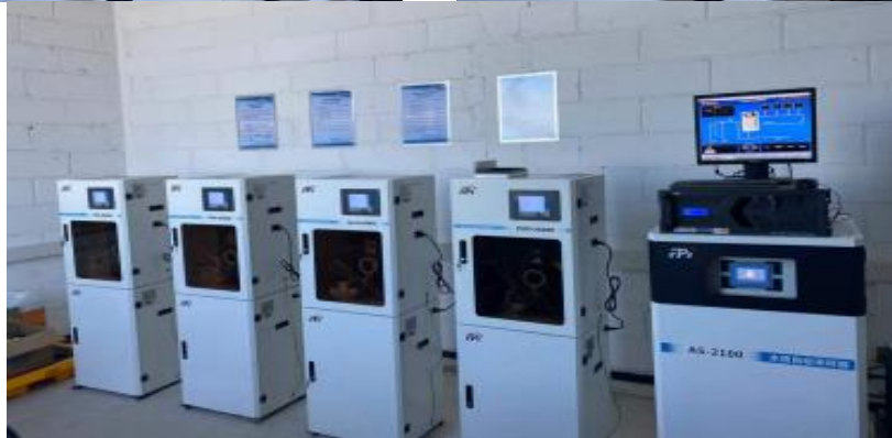
废水在线监测设备 PH、流量、COD、氨氮、总磷、总氮
