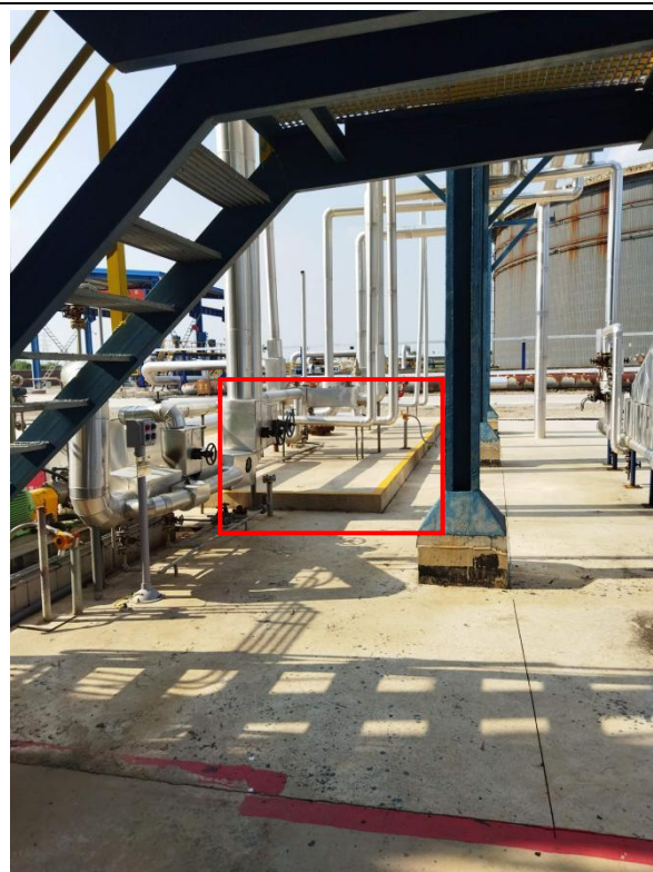
地下水酸性水-污油收集罐
