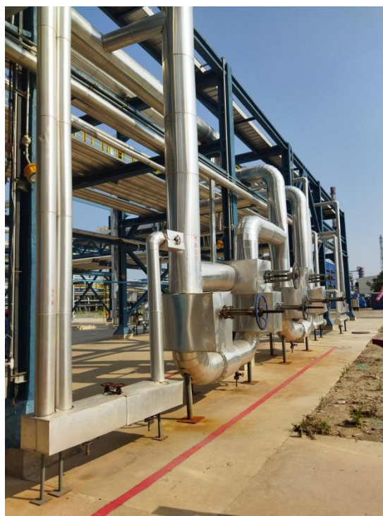
脱气罐废气、酸性水储罐呼吸废气管网
