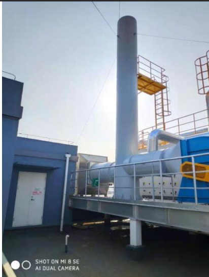
喷漆废气处理催化氧化处理设施 和排气筒 P7
