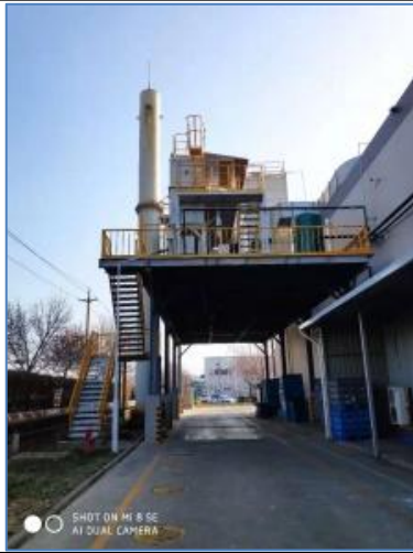
喷漆废气 RTO 处理设施 和排气筒 P2
