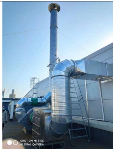
注塑成型废气活性炭吸附处理设施 和排气筒 P6
