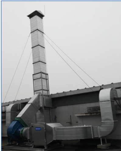
注塑成型废气活性炭吸附处理设施 和排气筒 P3
