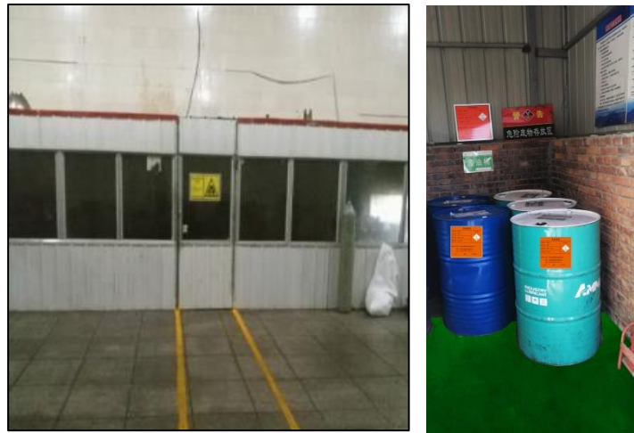
图 6 危废暂存间规范化设置
