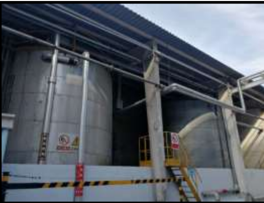
燃料油储存罐
